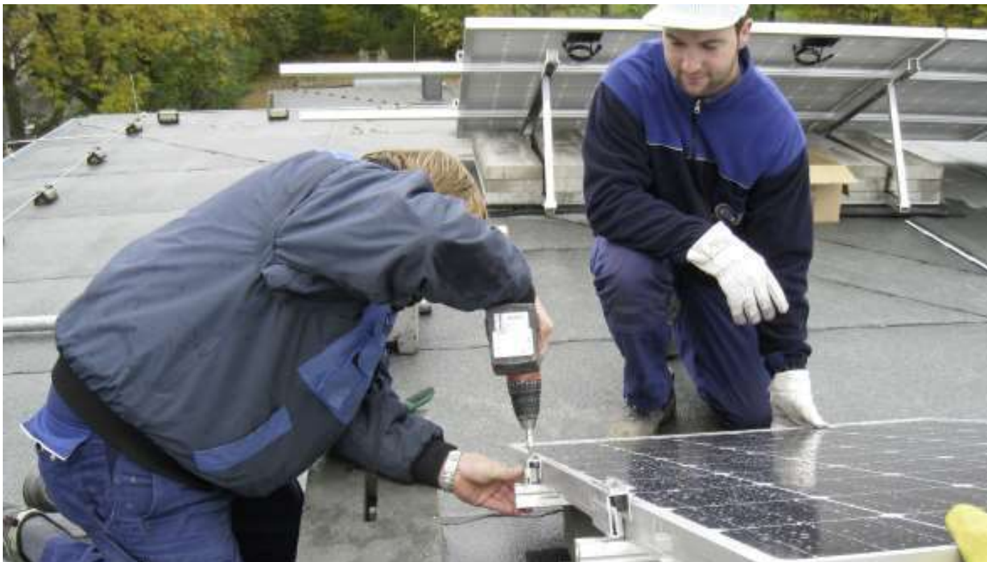
Der Meister zeigt dem Auszubildenden, wie die Arbeiten an einer Photovoltaikanlage in der Praxis durchgeführt werden.
